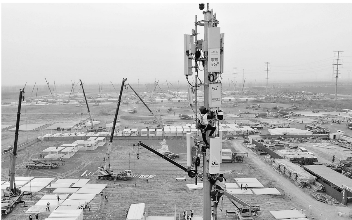
▲1月15日,工人在石家庄黄庄公寓隔离场所项目工地安装5G通讯设备(无人机照片)。
