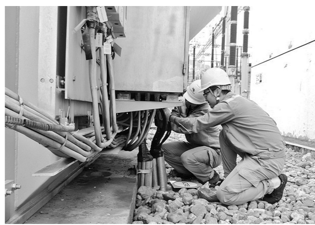
▲值班员对主变本体端子箱进行防潮检查。(吴南宏 摄)
